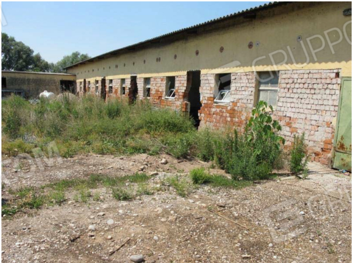
Vista dal cortile interno della Stalla Fabbricato A e stato di degrado
