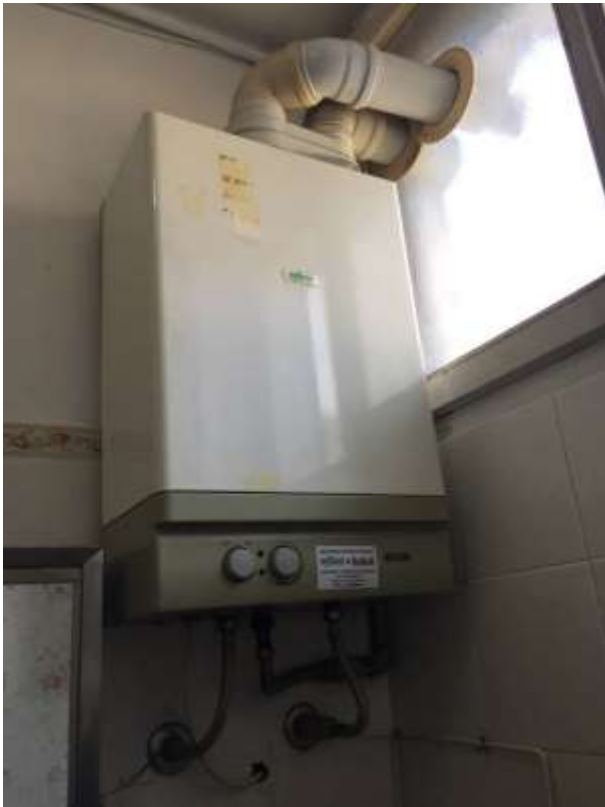
Figura 14: Caldaia nel locale bagno
