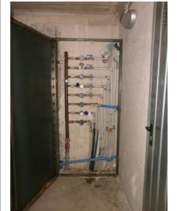
N. 51 - Dettaglio quadro contatori acqua.
