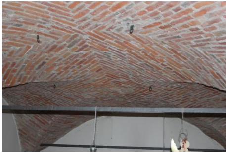
Foto 17 – soffitto soggiorno sub. 9
