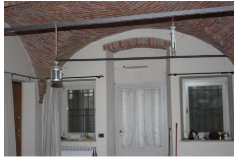
Foto 16 – soffitto soggiorno sub.9
