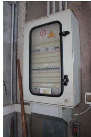
Foto 6 - Particolare quadro elettrico sub. 6
