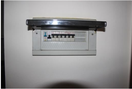
Foto 15 Impianto elettrico a norma
