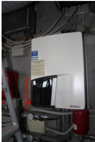
Foto 7 - Particolare caldaia sub. 6
