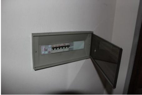
Foto 7 sub 61 Impianto elettrico a norma
