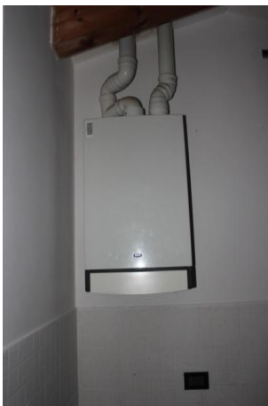
Foto 5 – Caldaia angolo cottura sub. 3
