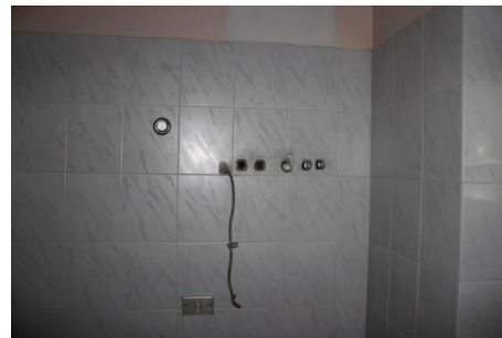
Foto 6 sub 61 La caldaia è stata asportata
