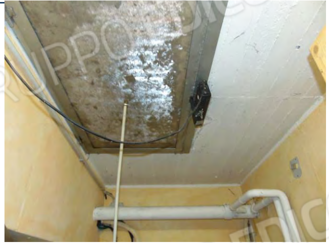
Difformità: cavedio chiuso con serramenti ciechi
