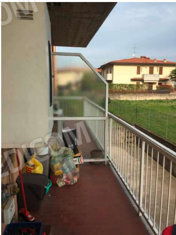
Terrazza retro con caldaia
