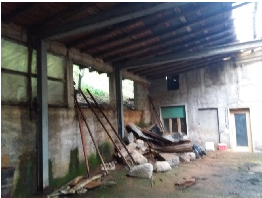
Vista lato ovest frana
