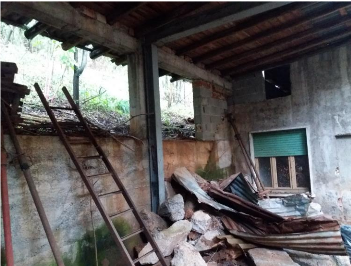
Vista lato ovest/nord frana
