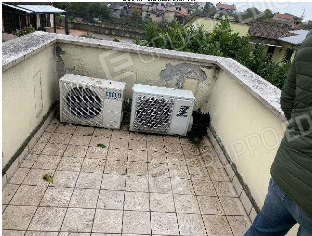
Terrazza al piano primo con motori del condizionamento
