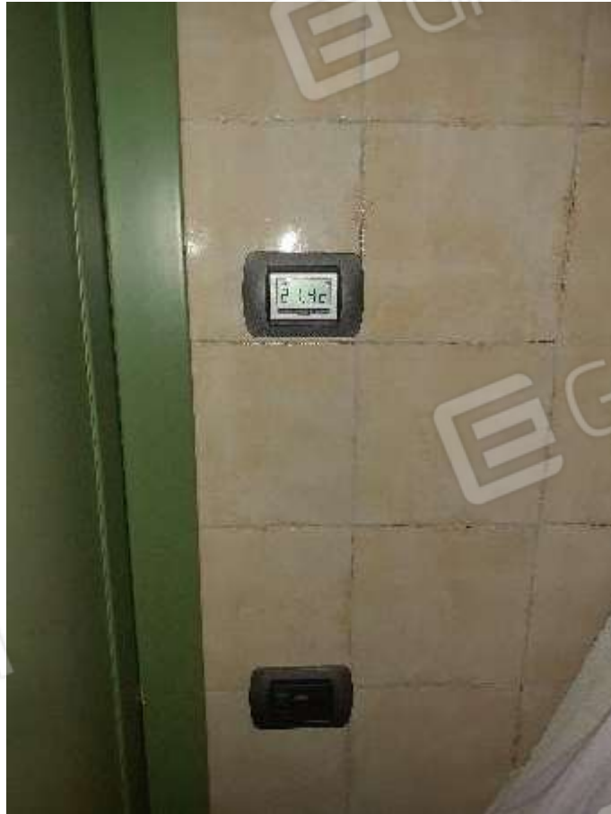
Termostato di zona in bagno
