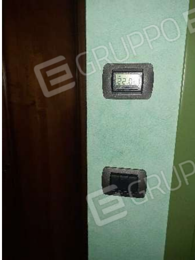
Termostato di zona piano secondo
