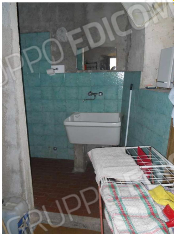
8 - Centrale termica con wc/lavanderia
