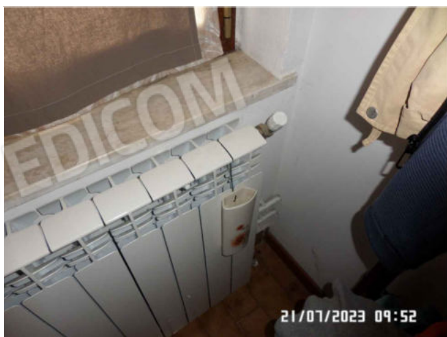
FOTO 44: Particolare calorifero camera al p. terra
