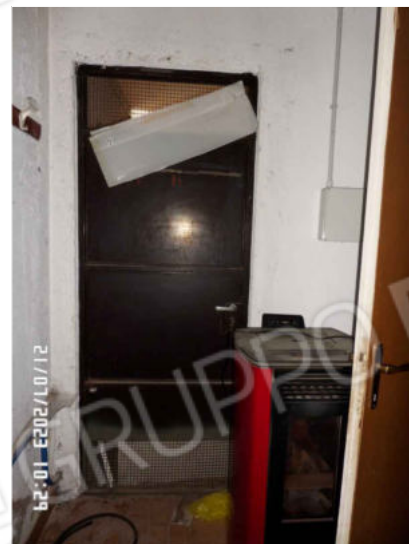
FOTO 43: Porta locale caldaia
