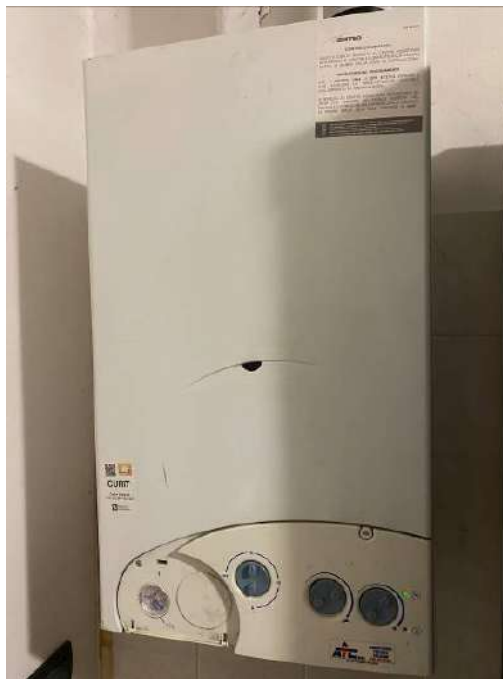
Figura 24: Caldaia installata nella lavanderia al piano interrato
