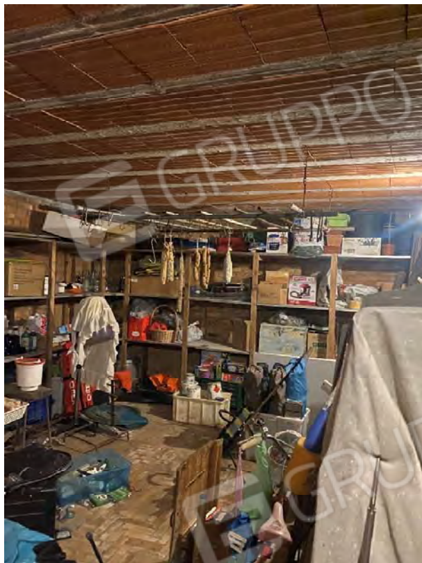
Cantina al piano seminterrato (non autorizzata)
