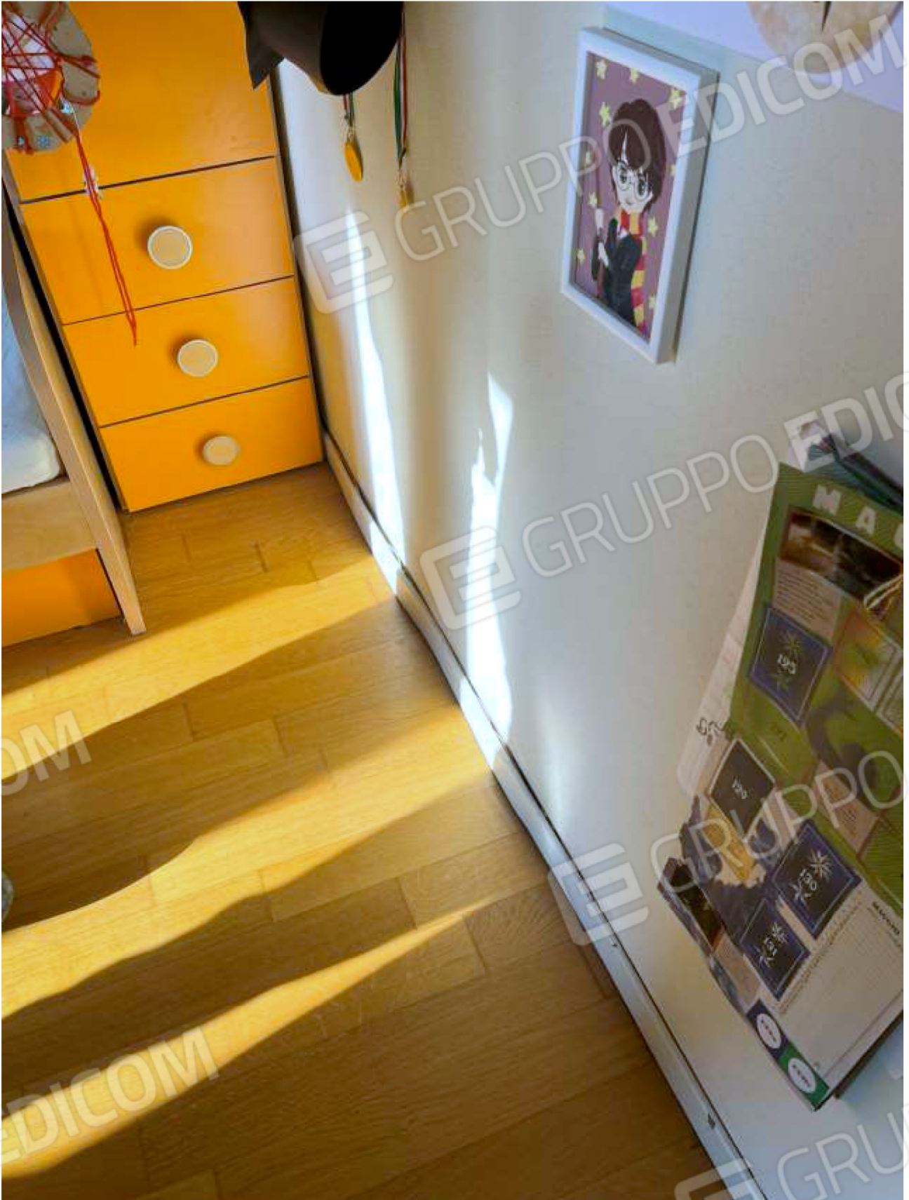
DANNI DA INFILTRAZIONE
