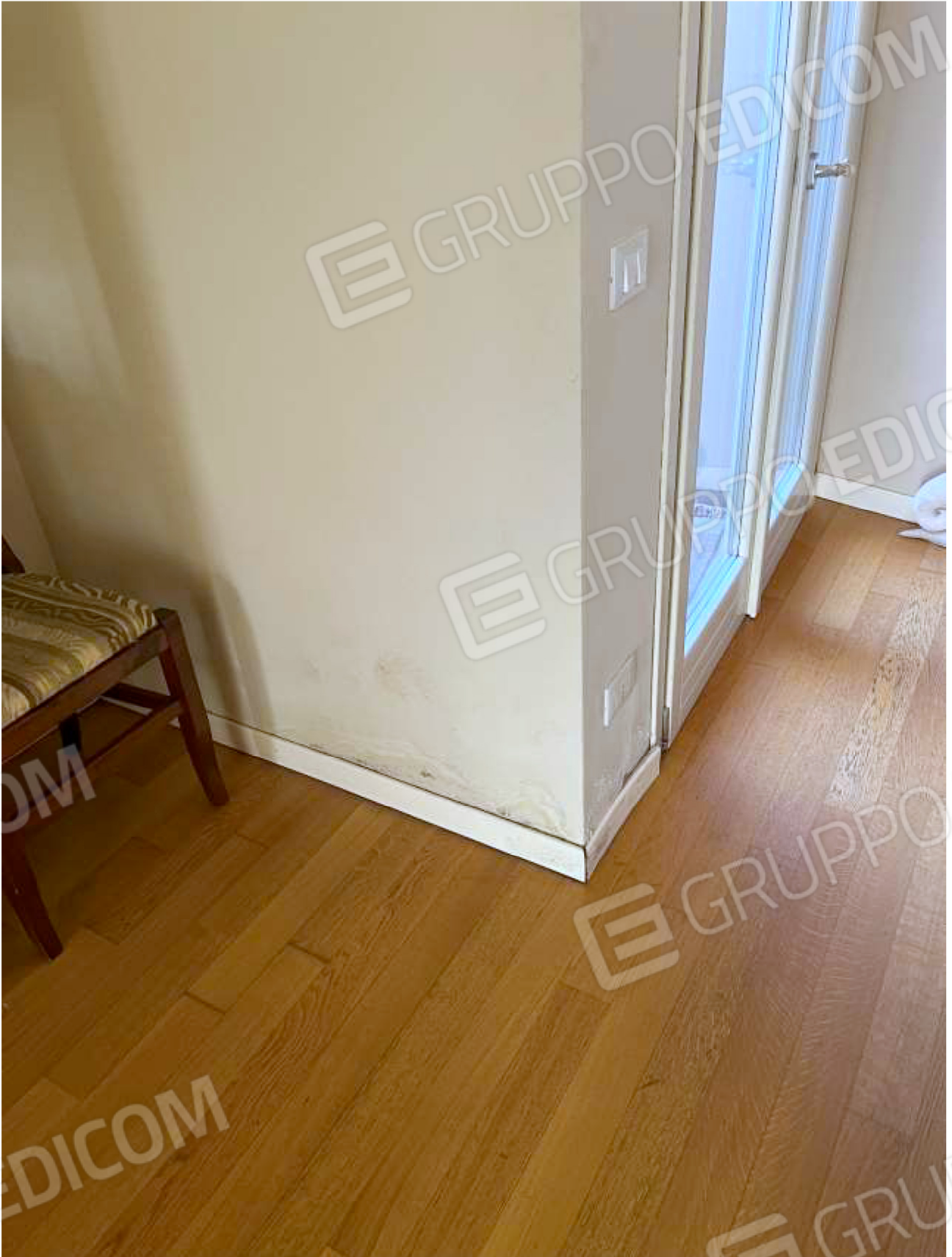
DANNI DA INFILTRAZIONE
