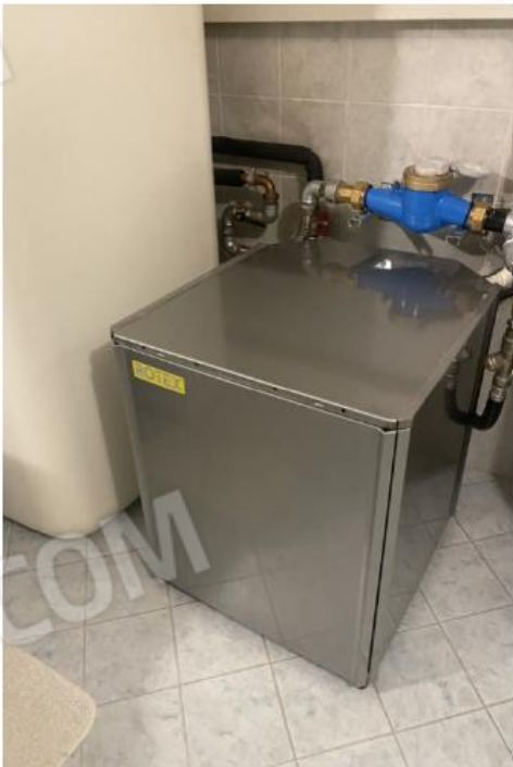
Loc. Caldaia Lavanderia
