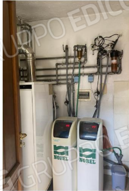
Locale caldaia Comune P. Terra
