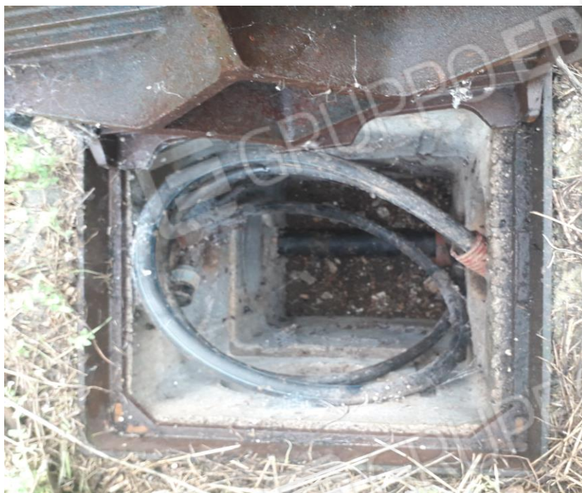
Pozzetto inerente la servitù di acquedotto
