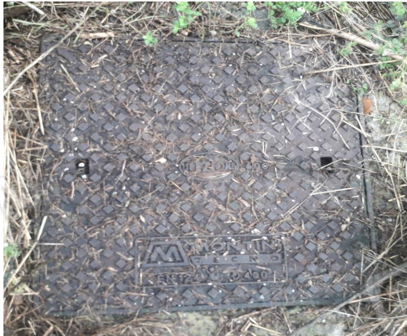
Pozzetto inerente la servitù di acquedotto
