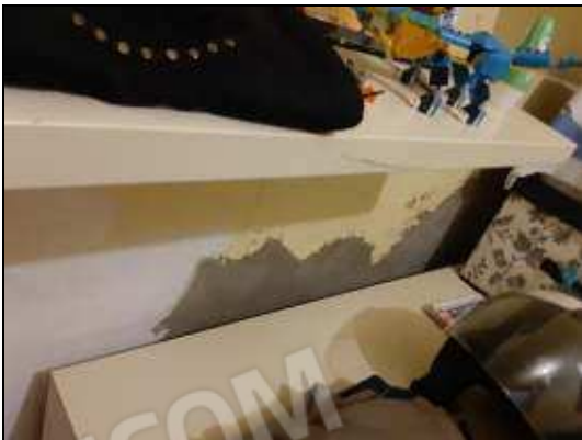
Problemi di umidità in camera sul lato parete comune con il bagno
