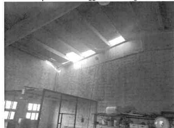
18 – Copertura danneggiata del magazzino
