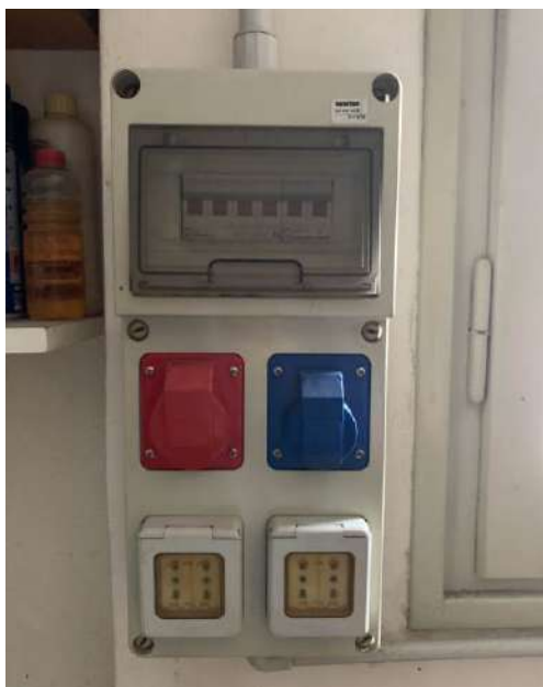
Quadro elettrico principale
