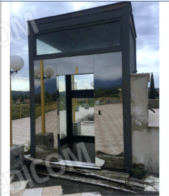
N. 97 15 - LOTTO B - Pizzeria - Particolare - ascensore 1P - Sub. 21
