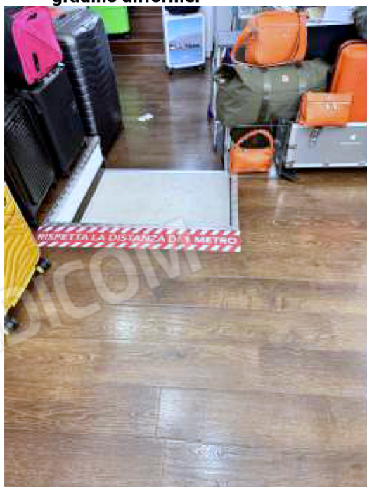
N. 43 Vista del particolare della porzione di gradino difforme.
