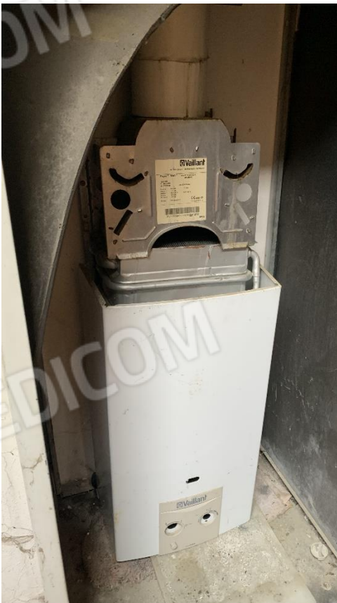
13 – Caldaia acqua calda sanitaria
