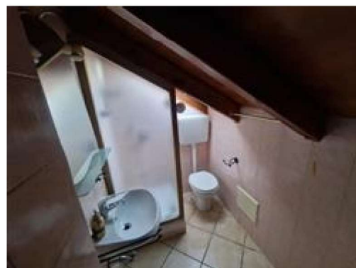
bagno abusivo nel sottotetto
