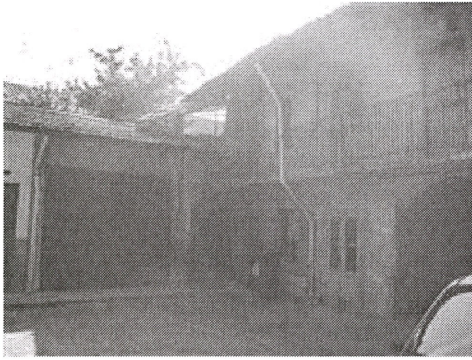
Foto allegate alla prima DIA 118/ 2003 - edificio a ringhiera crollato e demolito e ammesso esistente
