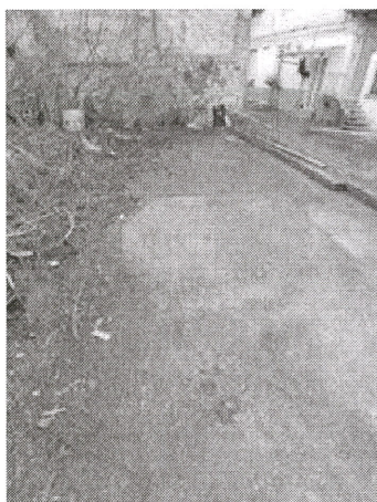
FOTO AREA DI SEDIME -PLATEA IN IGLOO E MASSETTO DI CEMENTO PER CREAZIONE VESPAIO E TRAVE DI FONDAZIONE
