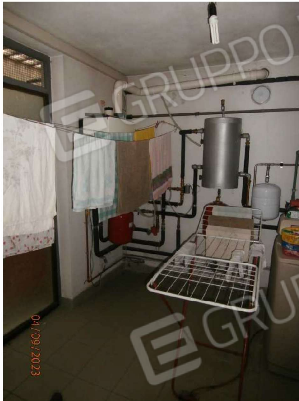
Vista interna centrale termica a piano interrato
