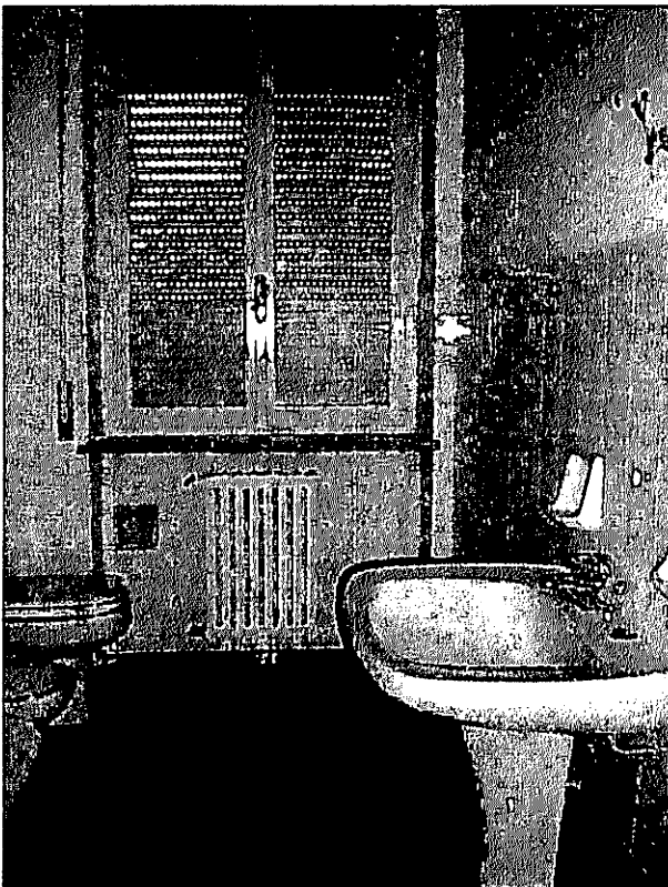
PIANO SECONDO (FOTO 04) STAGIONATURA
