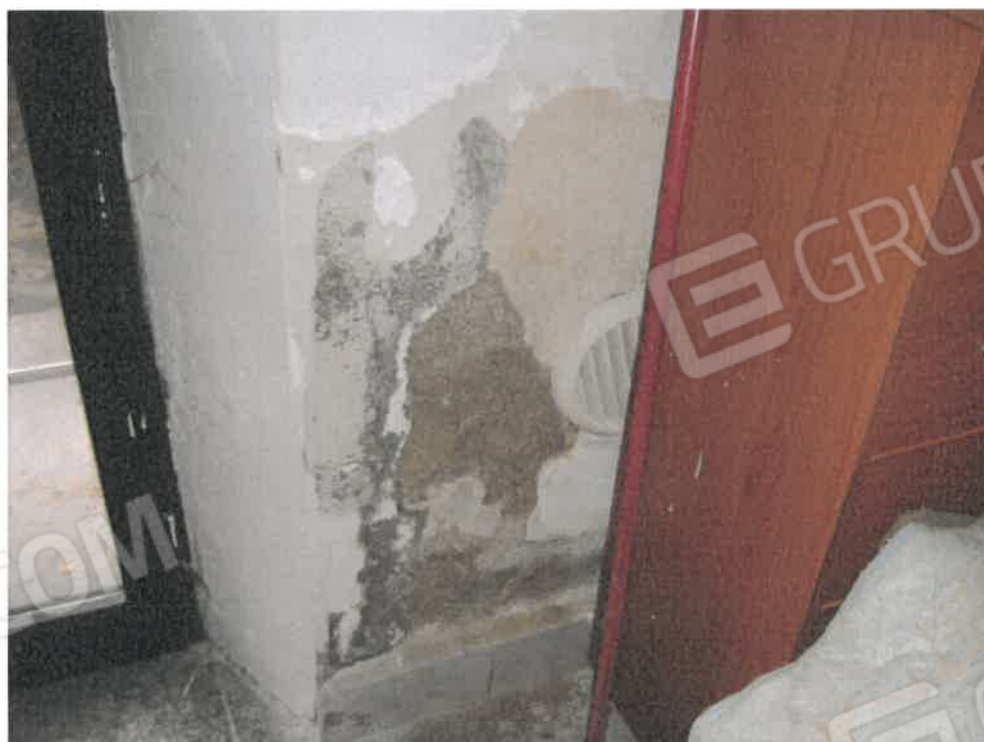
Ingresso / soggiorno – ammaloramenti parete nord
