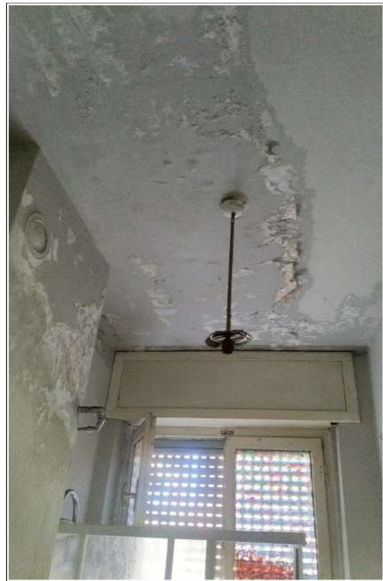
Le condizioni del plafone del bagno
