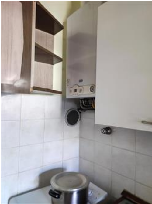
Particolare caldaia murale
