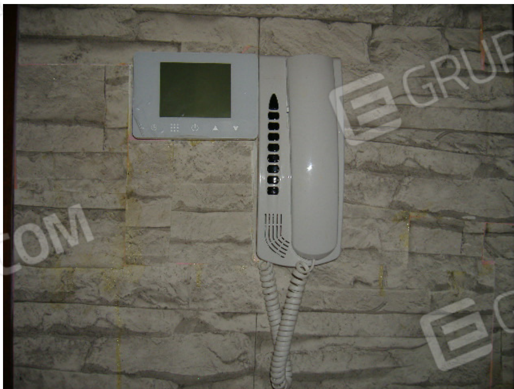
Termostato ambiente e citofono (disimpegno)
