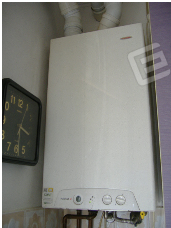
Generatore per Riscaldamento e ACS (Cucina)
