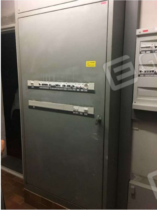
22. DETTAGLIO OPERE SVOLTE: quadro elettrico parti comuni
