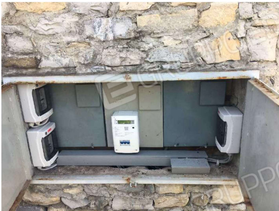
30. DETTAGLIO OPERE SVOLTE: vano contatore ENEL esterno
