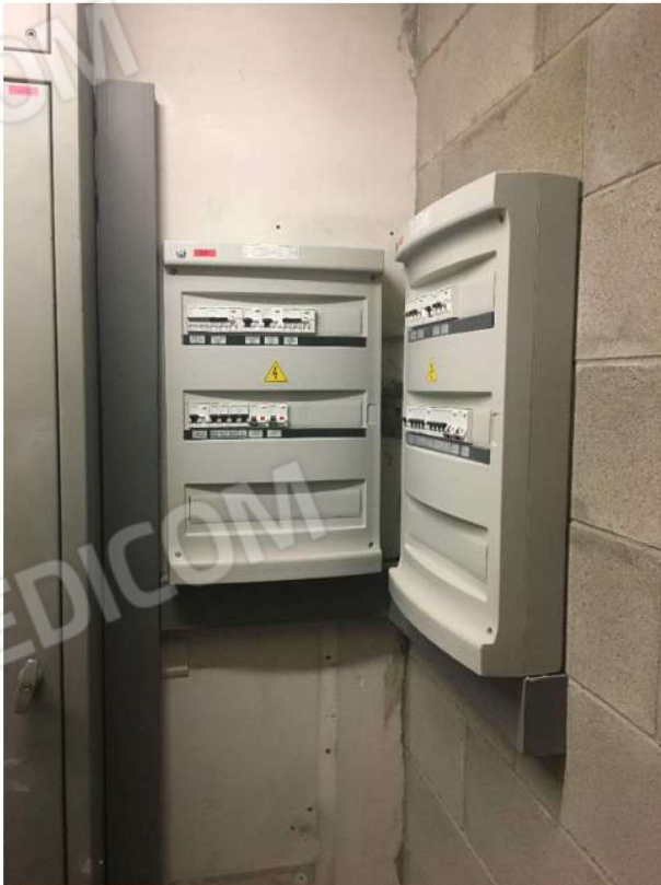
23. DETTAGLIO OPERE SVOLTE: quadri elettrici unità distinte
