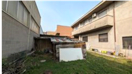
tettoie esterne non autorizzate, con possibile presenza di amianto
