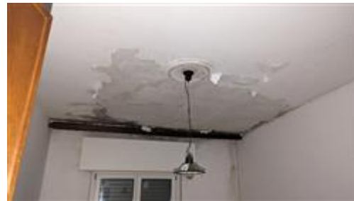
distacco e scrostamento dei plafoni, presenza di muffa e umidità
