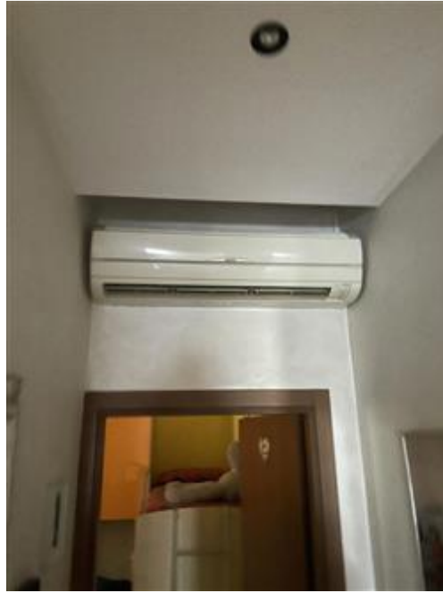
split collocato nel disimpegno
