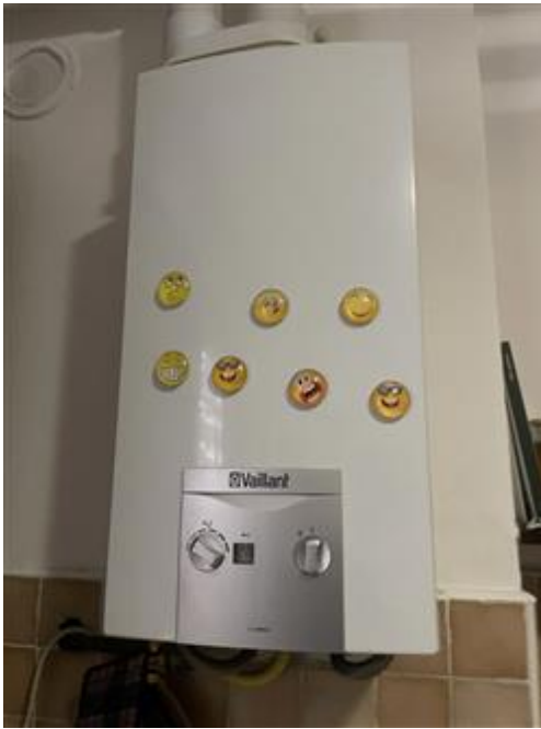
scaldabagno ubicato in cucina
