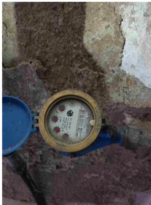
contatore acqua comune interno alla cantina
