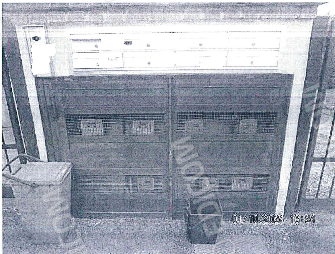
Contatori su strada
