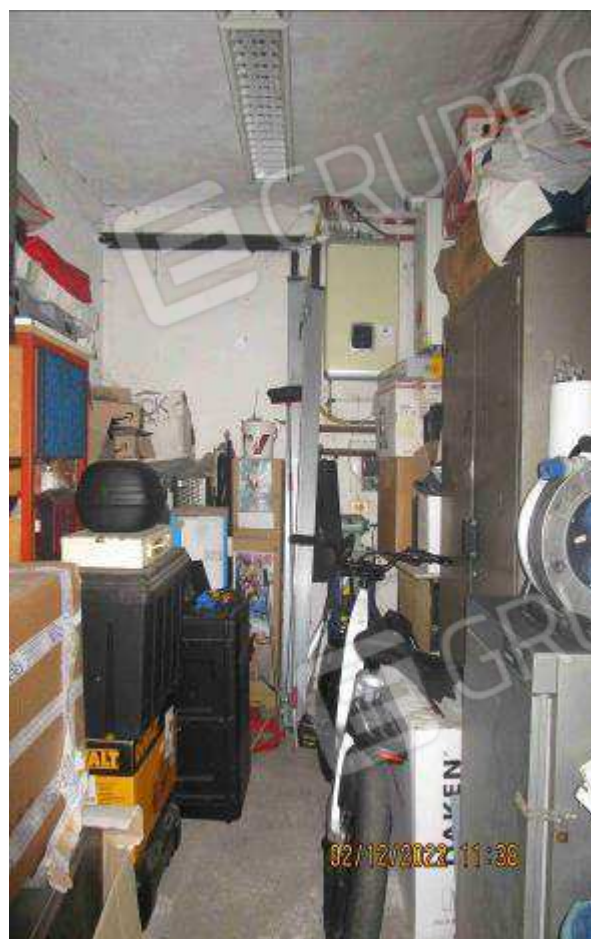
Centrale termica PT
