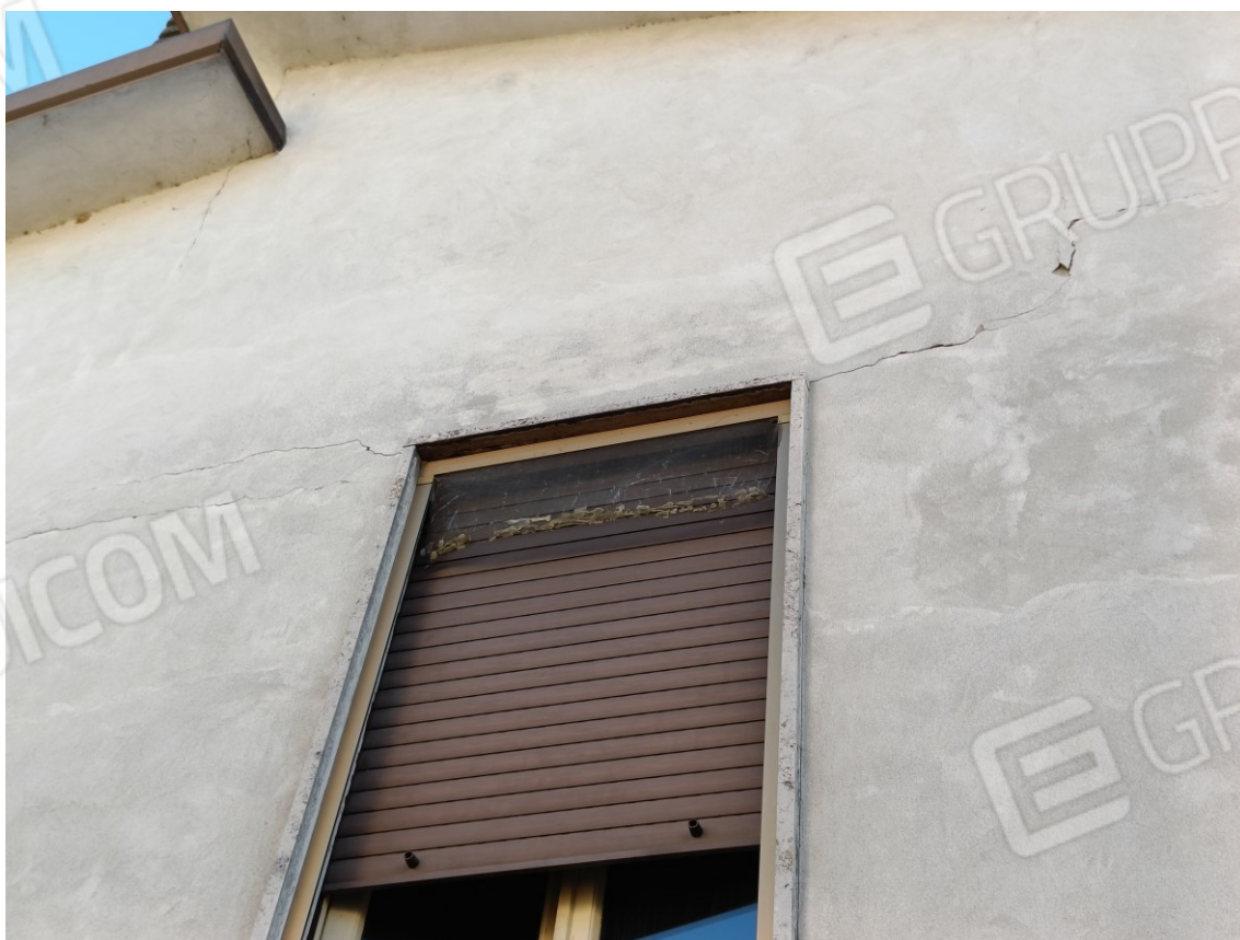
prospetto nord (particolare lesione)
