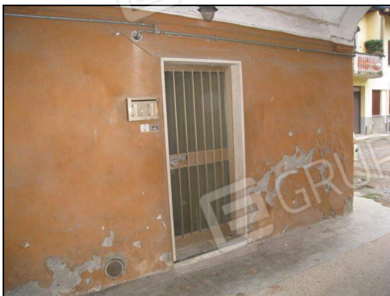
FOTO 6 VISTA ESTERNA RIPRESA NELL'ANDRONE COMUNE VERSO L'INGRESSO ALLA PORZIONE DI ABITAZIONE IDENTIFICATA DAL MAPPALE 1458 SUB. 1 OGGETTO DI PROCEDURA.
