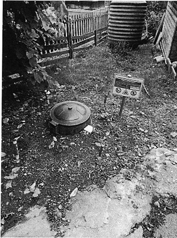
SERBATOIO GPL INTERRATO
