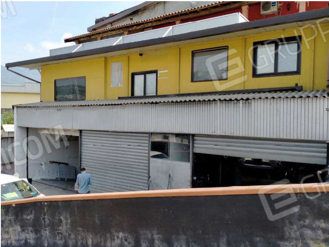
VISTA ESTERNA OVEST (PT e PS1) ampliamento non autorizzato
