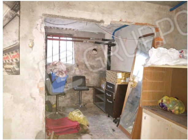
Locale caldaia P.S1
