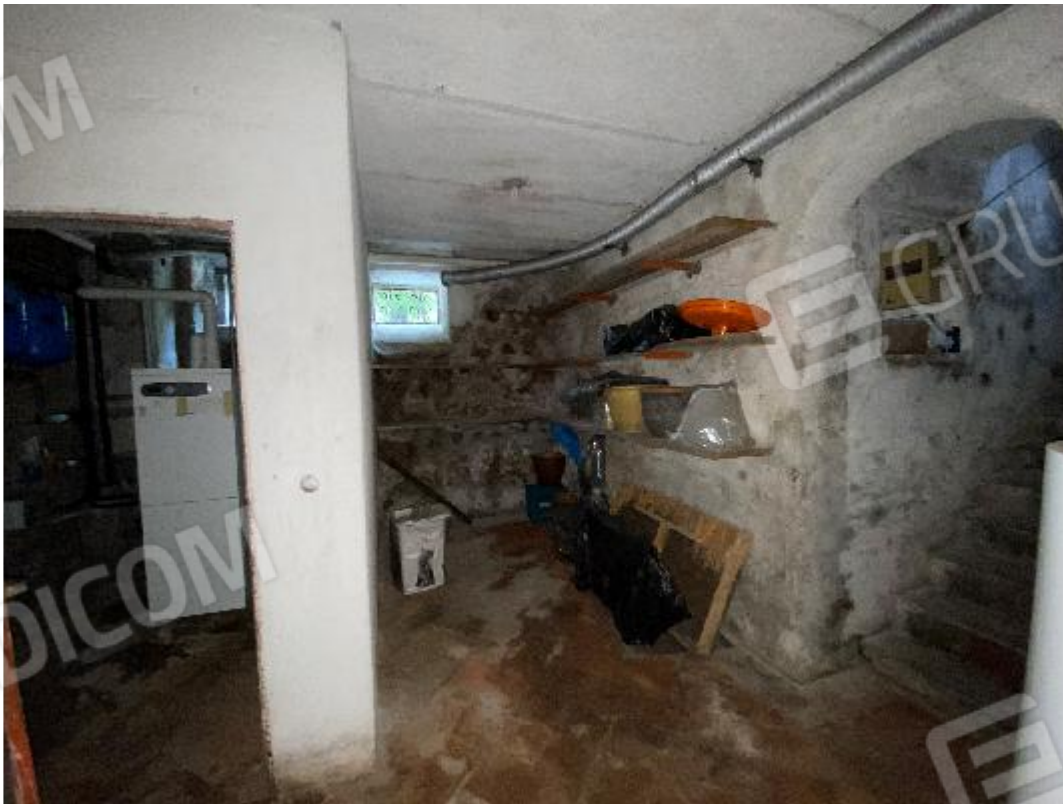
29. cantina con centrale termica
