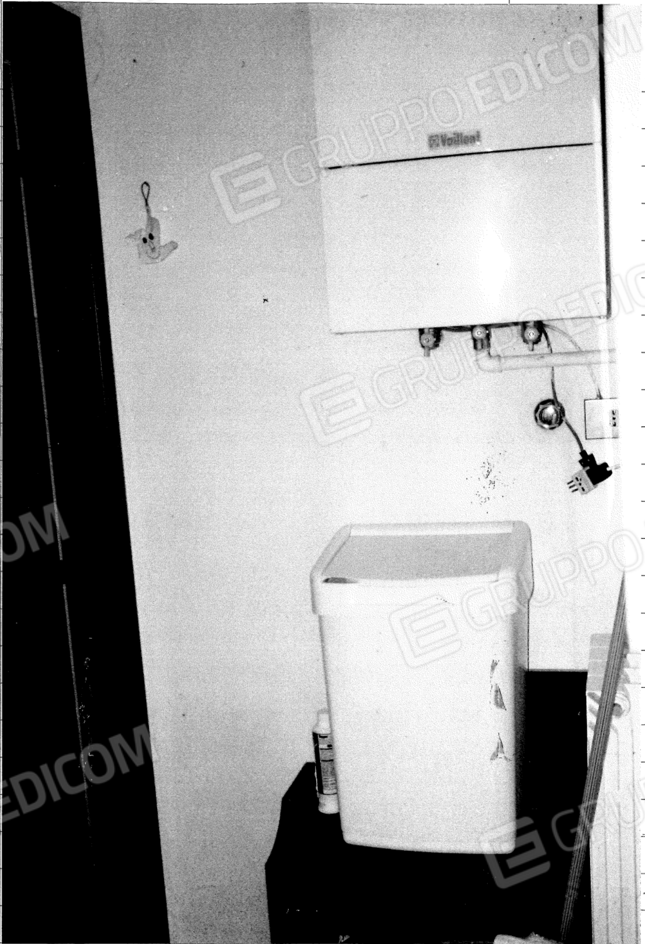
FOTO N. 15 – Impianto di riscaldamento acqua.
