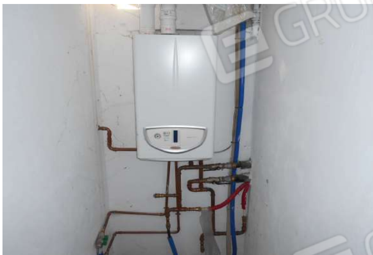
interni - secondo piano ristrutturato - impianto riscaldamento
