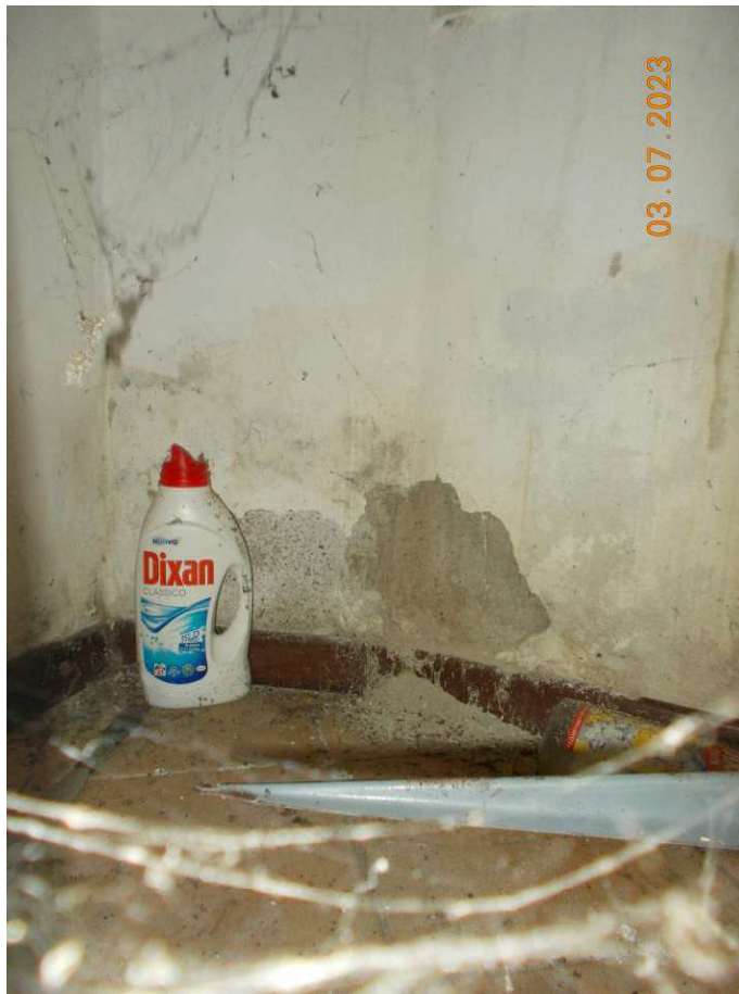
Foto 7 'corpo A' – umidità di risalita zona cottura
