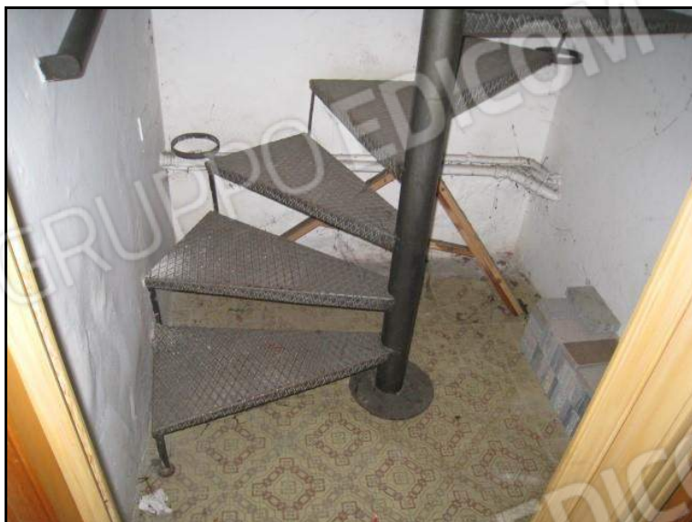
FOTO 16 PIANO TERRA PORZIONE DI ABITAZIONE U.I. MAPPALE 1458 SUB. 1 VISTA SCALA CHIOCCIOLA IN FERRO DICOLLEGAMENTO CON IL PIANO PRIMO.
