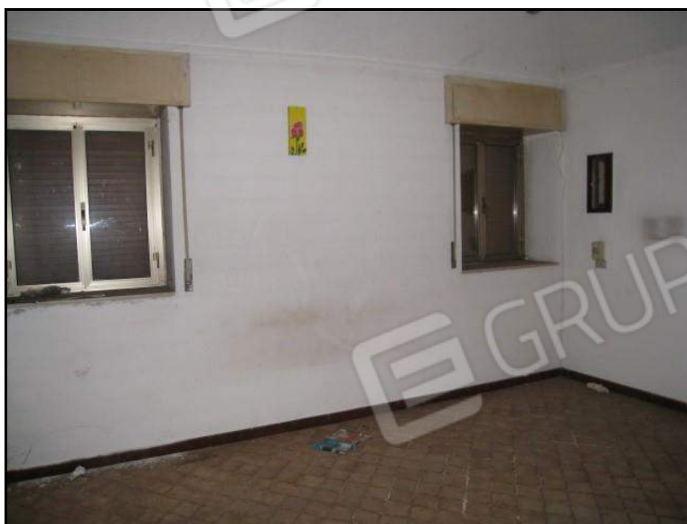
FOTO 9 PIANO TERRA PORZIONE DI ABITAZIONE U.I. MAPPALE 1458 SUB. 1 VISTA RIPRESA NEL LOCALE SOGGIORNO/ANGOLO COTTURA.
