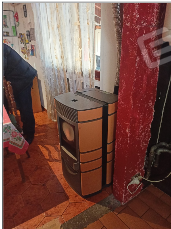
vista stufa riscaldamento
