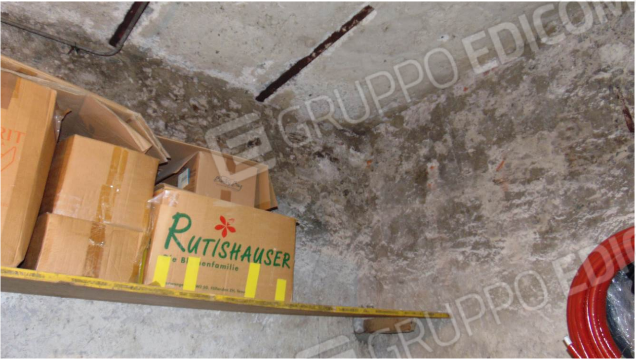
Foto 12: dettaglio intradosso in angolo locale ripostiglio
