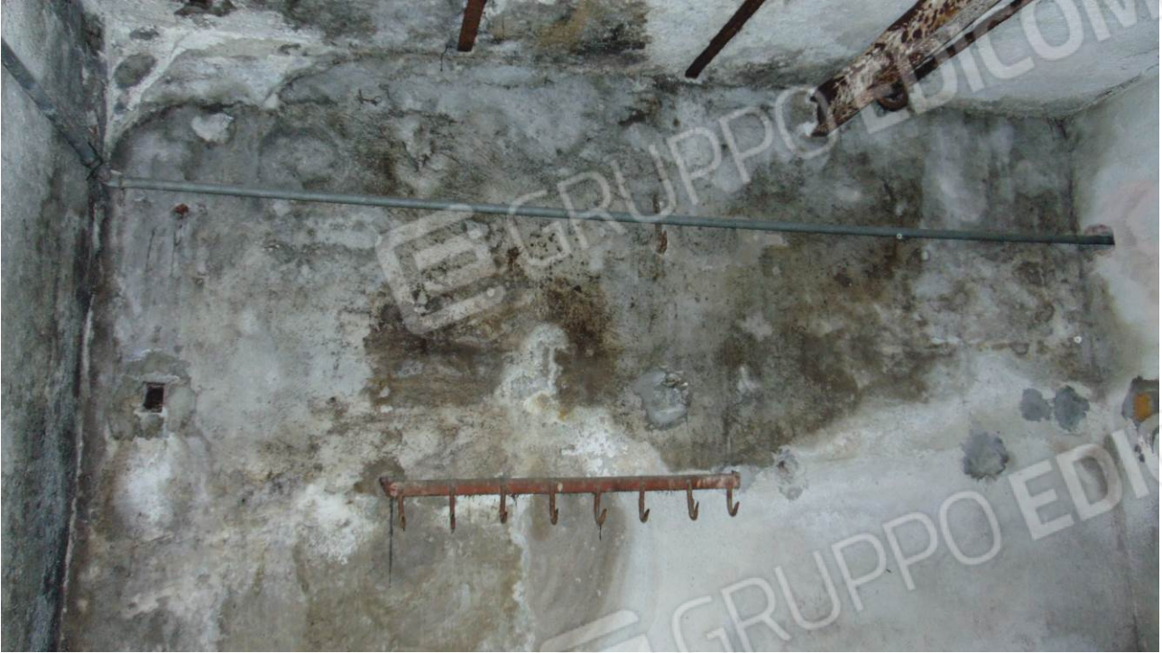
Foto 11: stato generale delle murature dei locali ad uso ripostiglio
